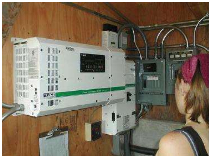
DC 発電での蓄電池以外の制御器類です。ソーラーに似ていますが、水力の場合ダミーロードが必要です。
