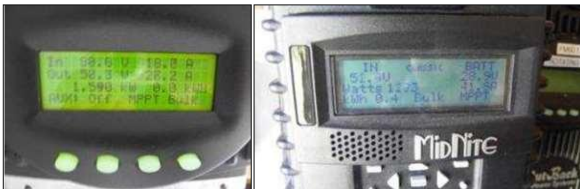
TRG80から1.6kWのMPPTを探すFM60 MC250 トラッキング、TRG80 から 1.23kW MPPT
